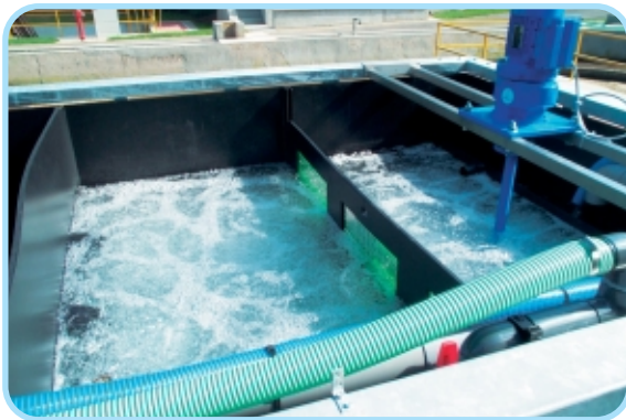
Station pilote sur le site de la station d'Hesperange
