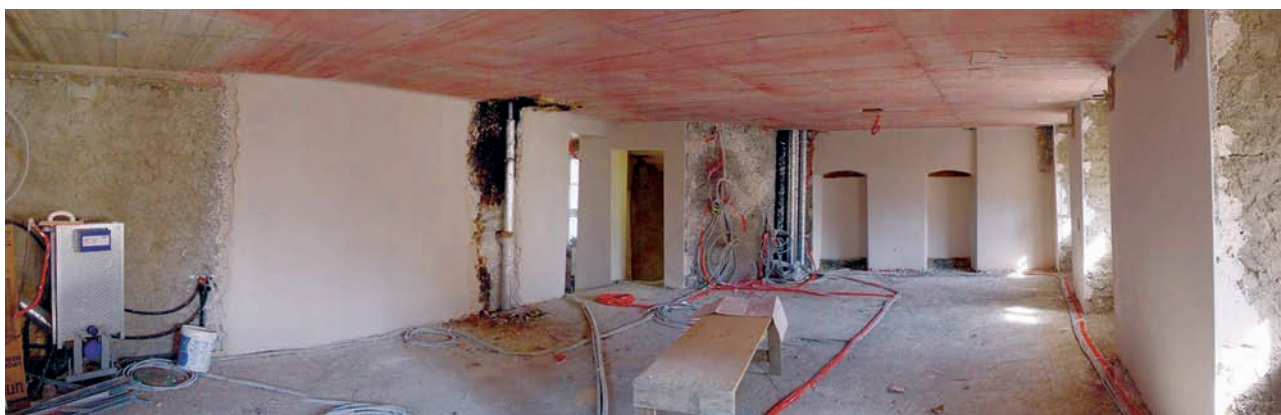
Travaux de rénovation: intégration des techniques, pose d'une nouvelle dalle en béton et d'un plancher dalle en bois avec chape de compression
