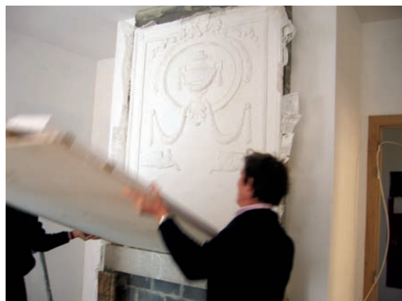
La pièce de style Louis XVI rénovée: restauration des éléments de la cheminée
