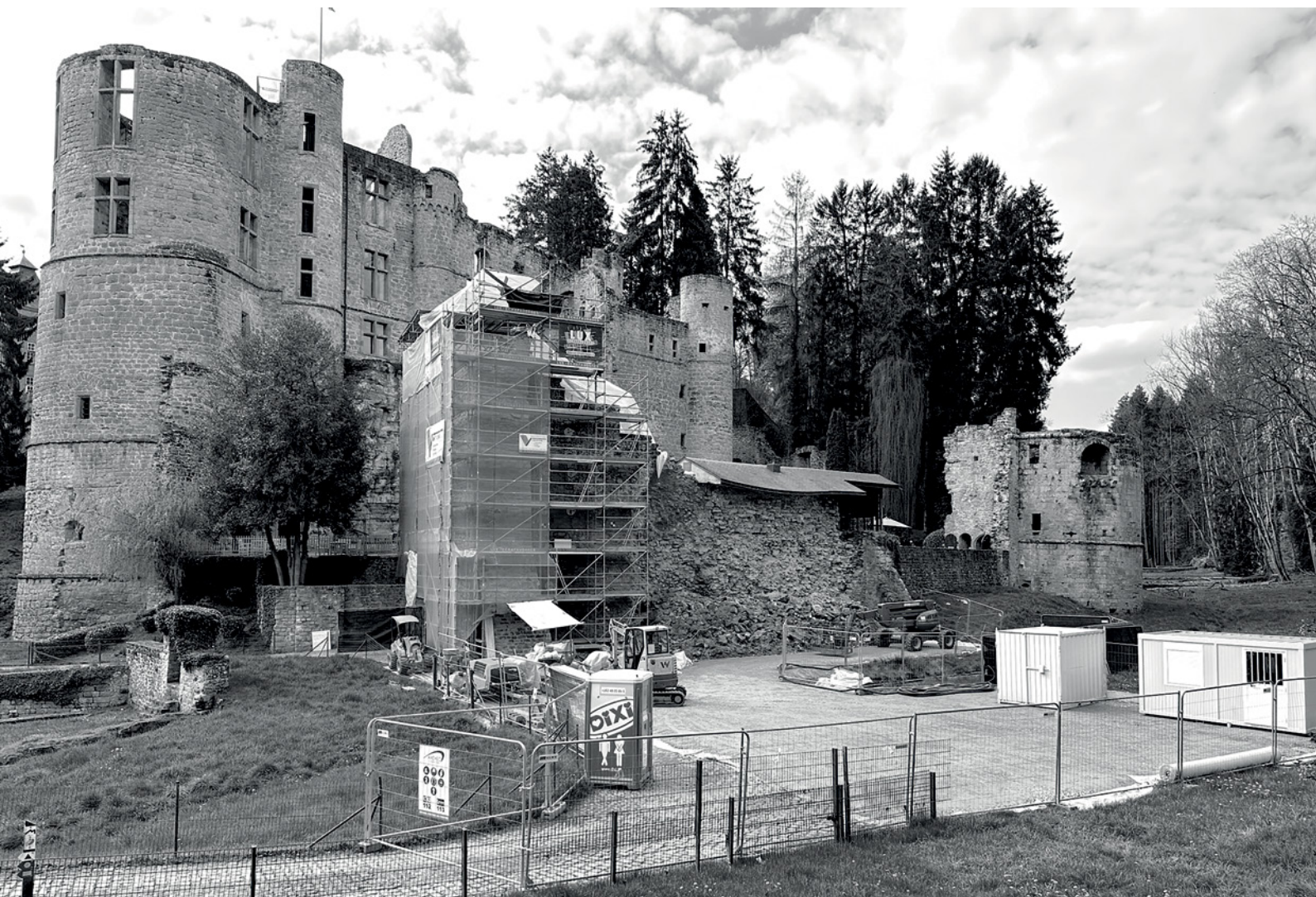
Châteaux de Beaufort - Château-fort – travaux de stabilisation de la muraille extérieure côté sud ; travaux de reconstruction de la muraille (2023) © INPA
