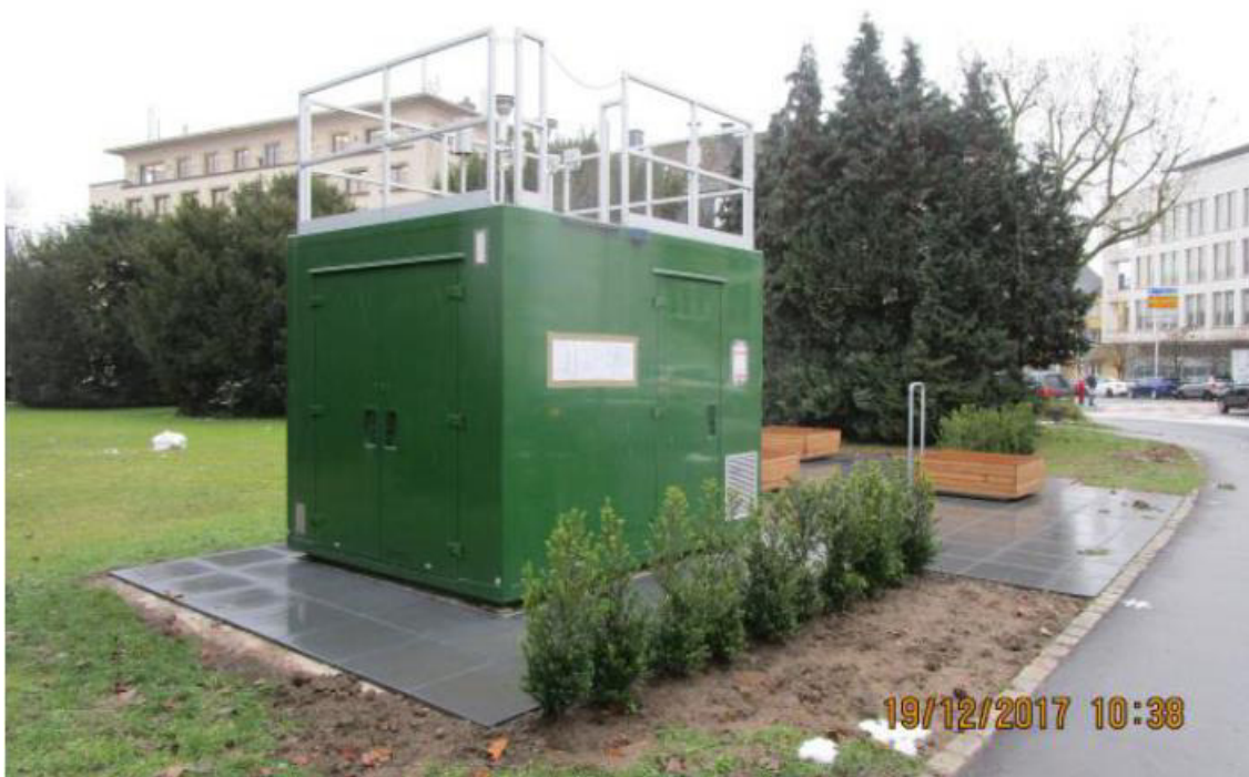
STATION DE MESURE TÉLÉMÉTRIQUE À LA PLACE WINSTON CHURCHILL À LUXEMBOURG-VILLE
